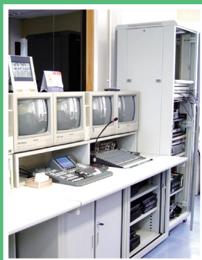
媒體創新中心控制室
